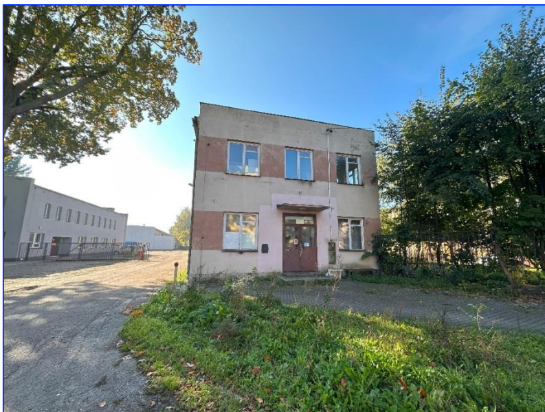
Ryc. 19 Nieużytkowany budynek przy ul. Pocztowej 30a
